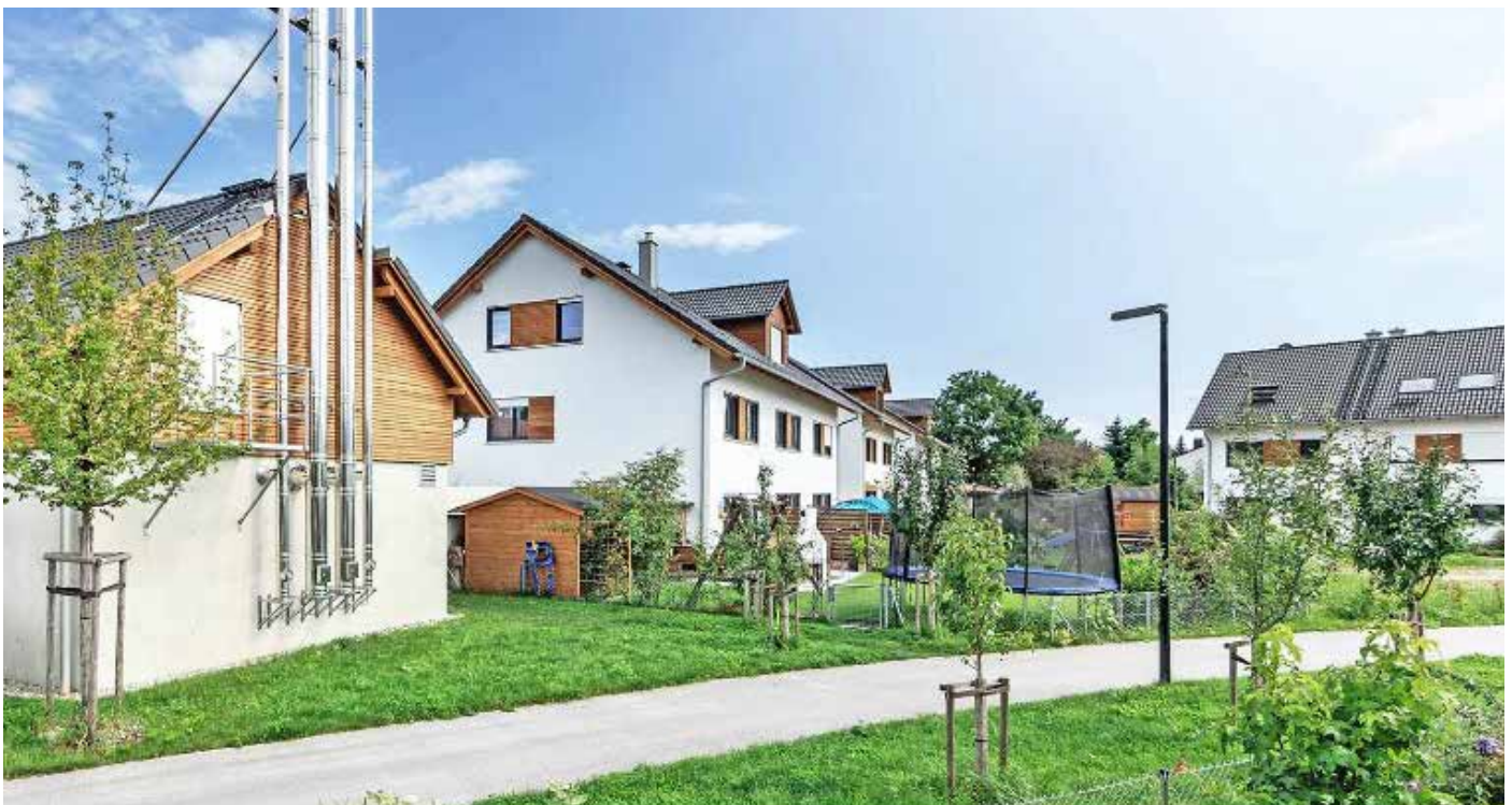
Abbildung 13: Heizzentrale des Nahwärmenetzes der ESB Wärme GmbH im Neubaugebiet „Angerwiese“ (Quelle: ESB Wärme GmbH)
